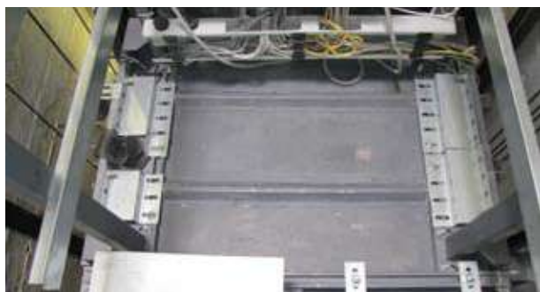
Techo de cabina sin alfombras antideslizantes
